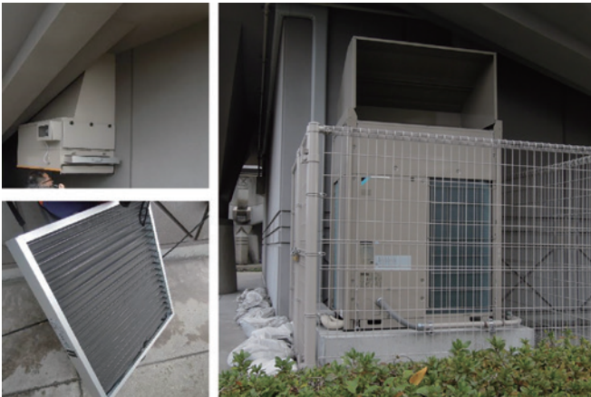
↑空調機器のフィルター
